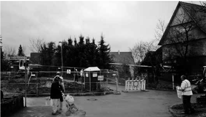
Die Erschließungsarbeiten für das kleine Baugebiet Widerscheinstraße/Wolfsgasse beginnen. Inzwischen sind diese abgeschlossen und schon einige der Bauplätze bebaut.
