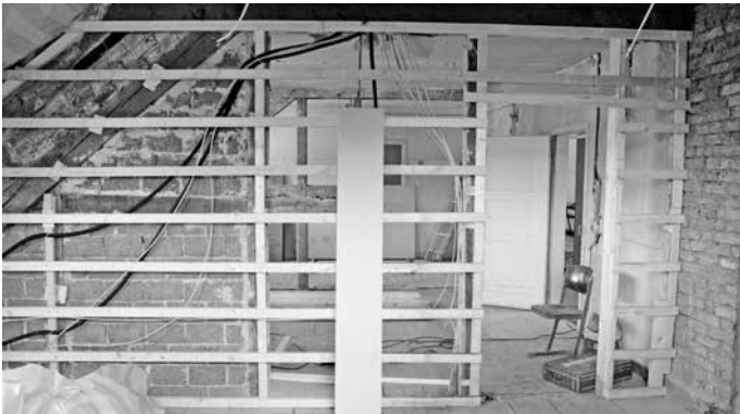
Während der Ferienzeit herrscht Hochbetrieb für die Handwerker an der Wittummschule. U.a. werden im Nordbau eine weitere Feuertreppe eingebaut und zusätzliche Räume für die Kernzeitbetreuung geschaffen.
