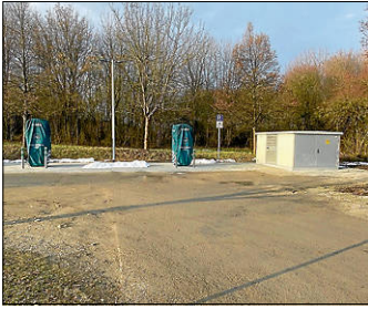
Diese Ladesäulen am P+M-Parkplatz müssen noch ans Stromnetz angeschlossen werden
