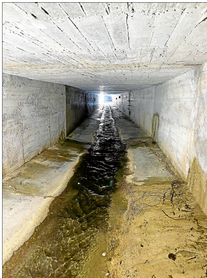
Urbachverdolung unter Hauptstraße Foto: Gemeinde Urbach
