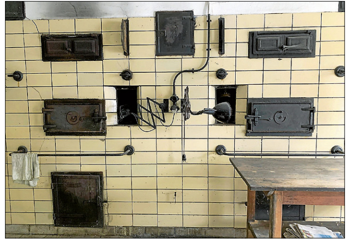
Blick auf die Backöfen im Backhaus Urbach-Süd im Gröbenwiesenweg 3
